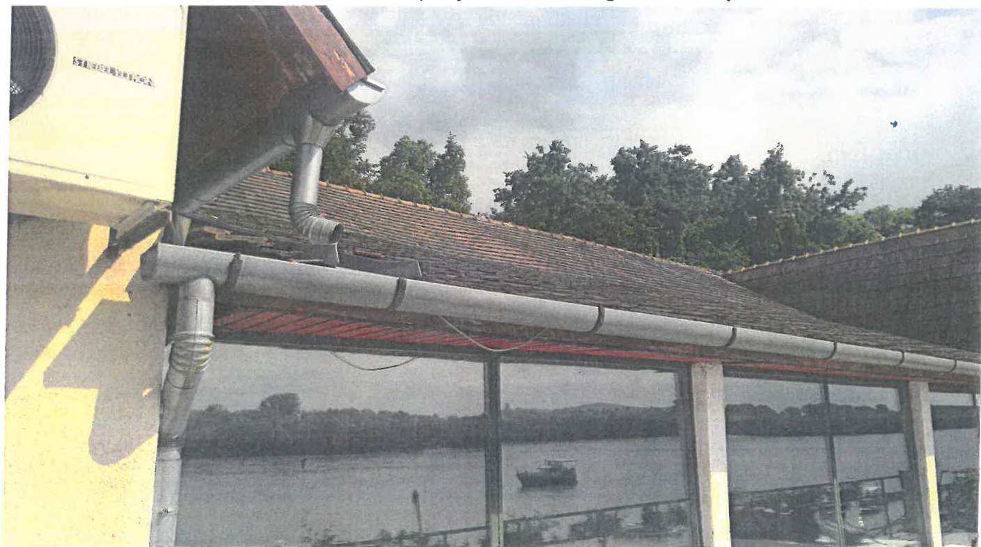
A szomszédos tetőszerkezet rossz állapota
