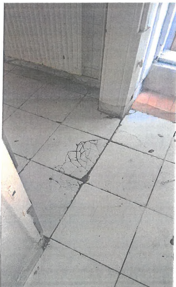
A padló meghibásodása
