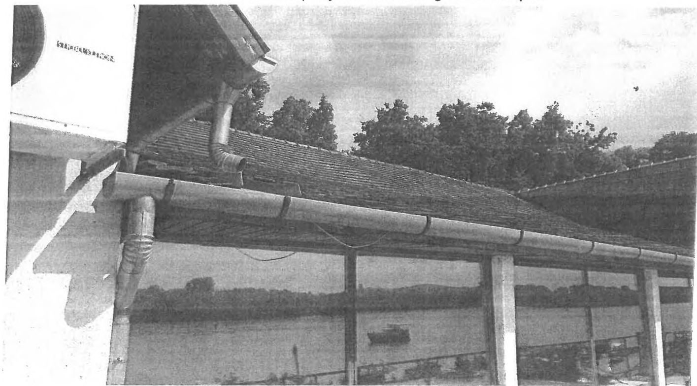
A szomszédos tetőszerkezet rossz állapota
