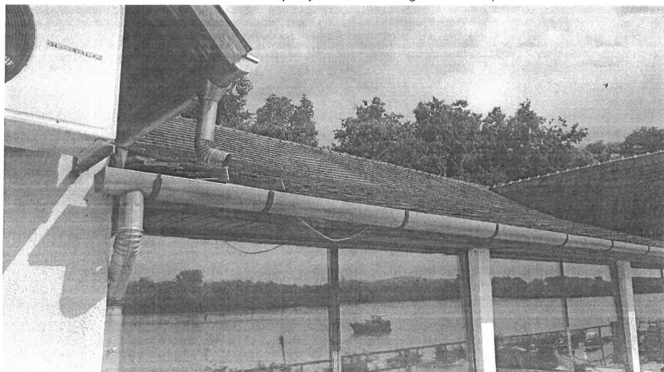
A szomszédos tetőszerkezet rossz állapota
