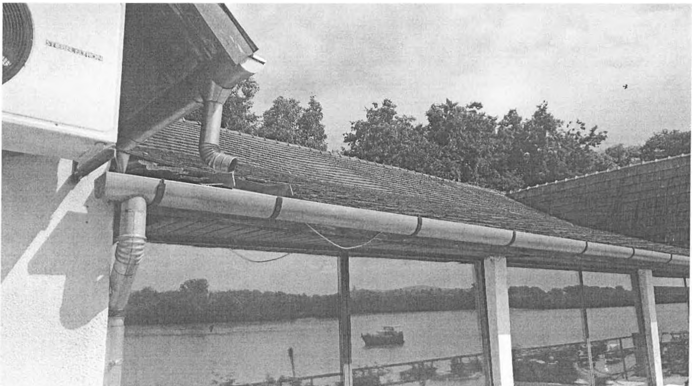
A szomszédos tetőszerkezet rossz állapota
