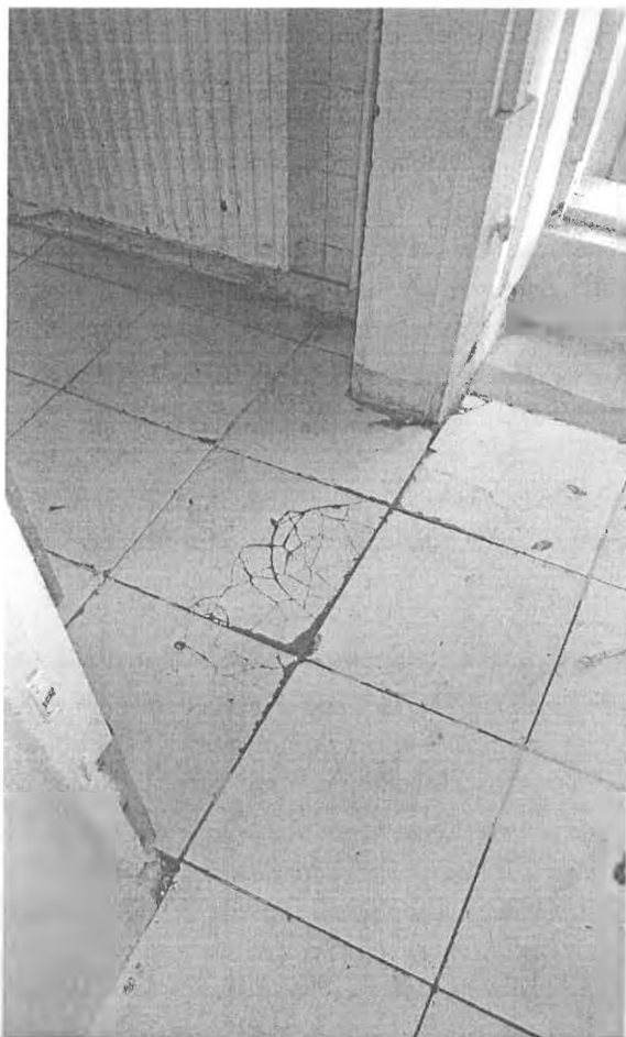
A padló meghibásodása
