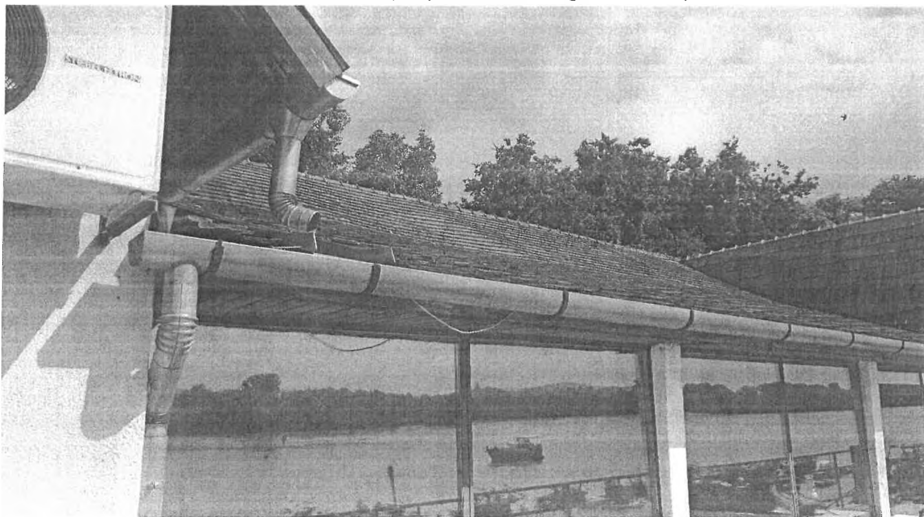
A szomszédos tetőszerkezet rossz állapota
