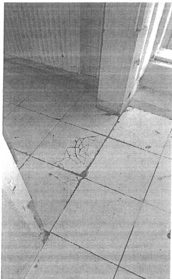
A padló meghibásodása
